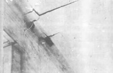
Los recios paraderos del monumental edificio de la Admana de Santiago de Cuba se abrieron en tal forma que hubo necesidad de desalojarlo por amenaza inminente peligro de ruina...
